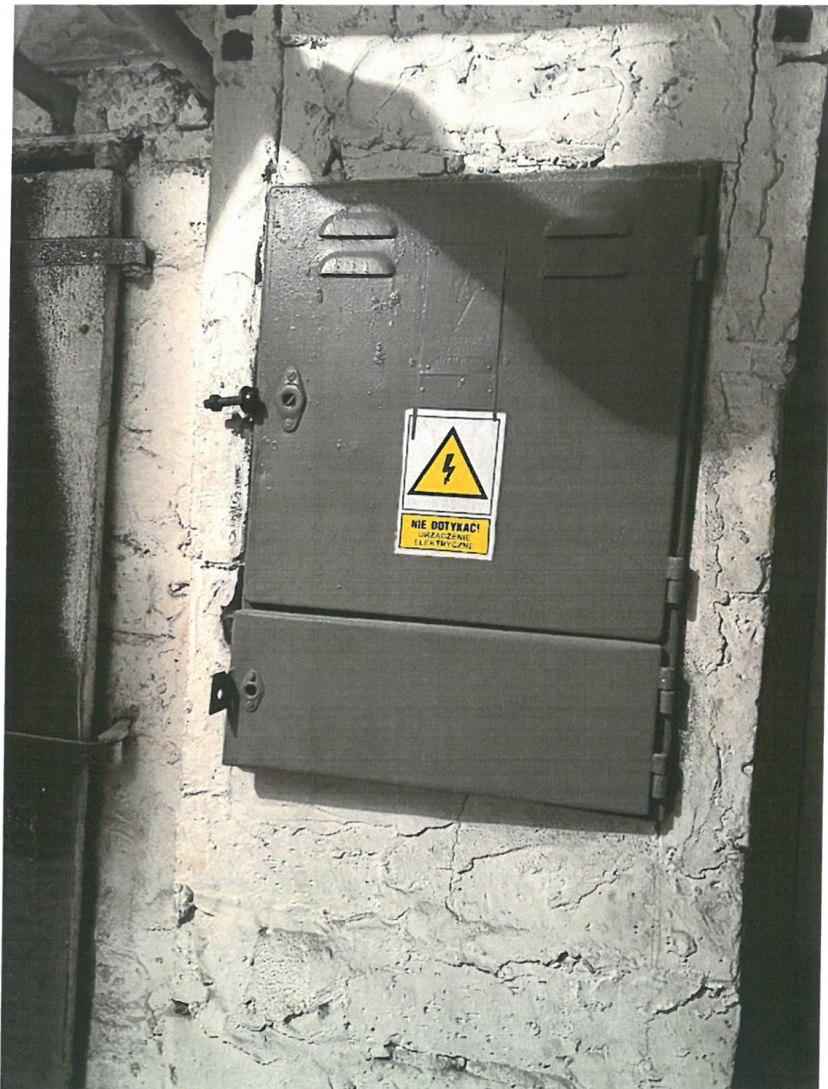
Fot.5. Tablica rozdzielcza z zabezpieczeniem pionów w obrębie piwnicy budynku nr 65. W piwnicy budynku znajduje się 6 takich tablic w wersji natynkowej i podtynkowej. Pojedyncza tablica zabezpiecza 1 pion po 11 mieszkań
