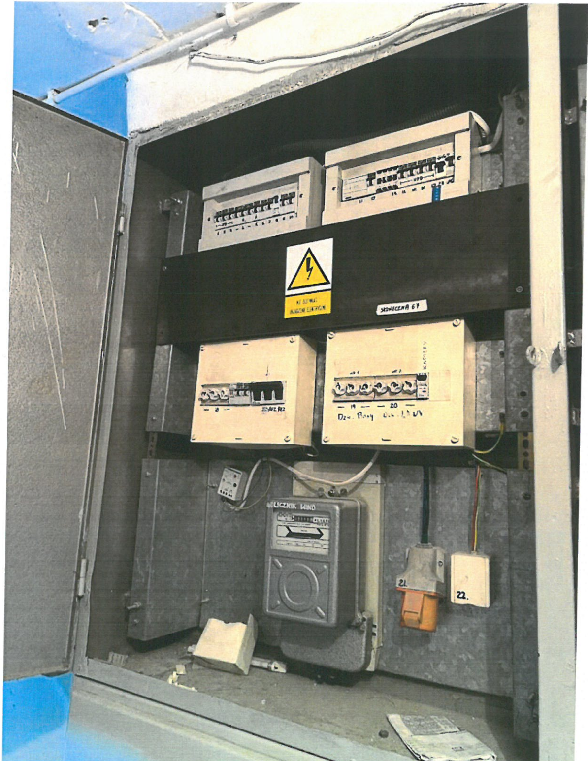
Fot.6. Tablica rozdzielcza główna RG budynku nr 67 – pole obwodów administracyjnych wraz z zabezpieczeniem pionów.
