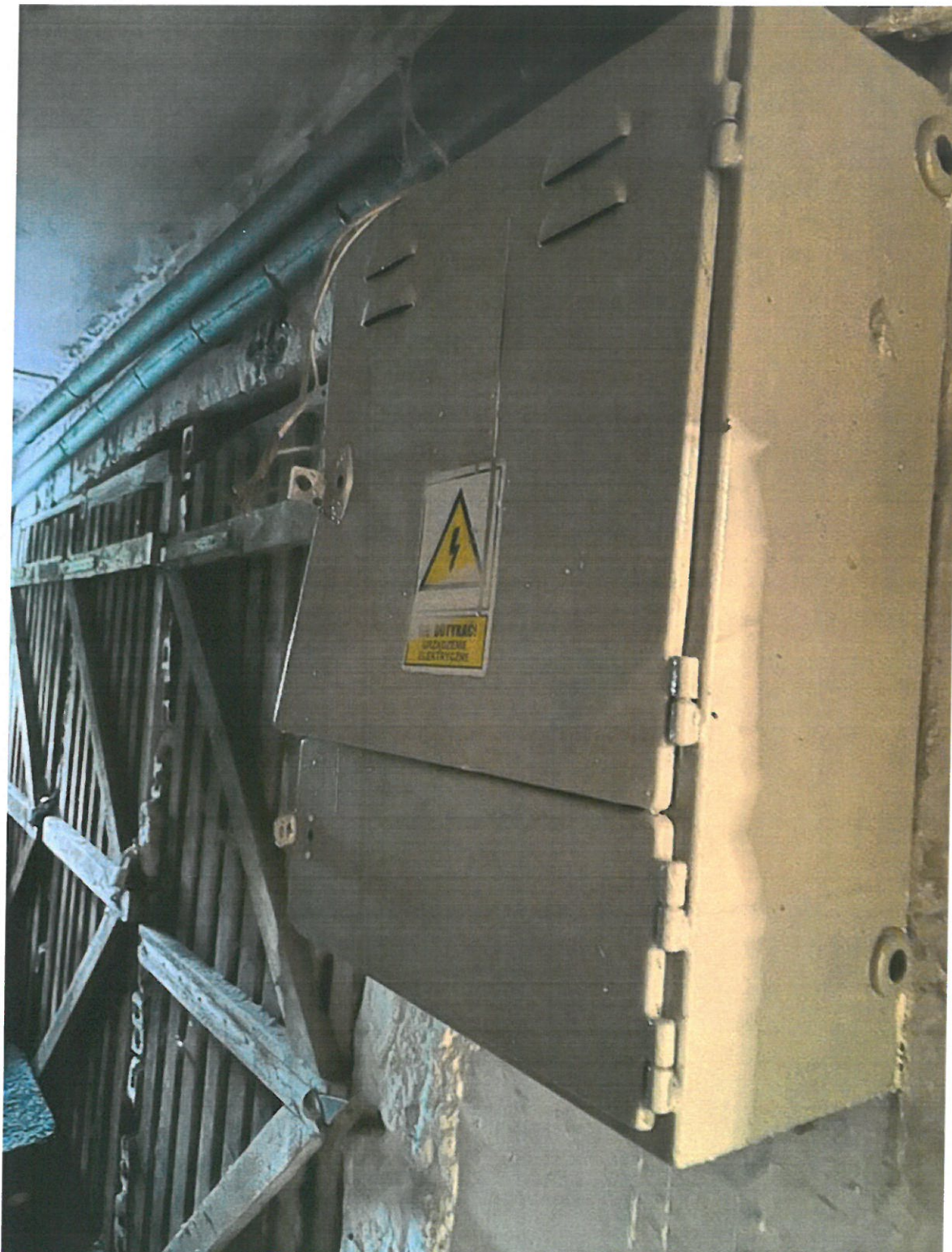
Fot.8. Tablica rozdzielcza z zabezpieczeniem pionów w obrębie piwnicy budynku nr 67. W piwnicy budynku znajduje się 6 takich tablic w wersji natynkowej. Pojedyncza tablica zabezpiecza 1 pion po 11 mieszkań
